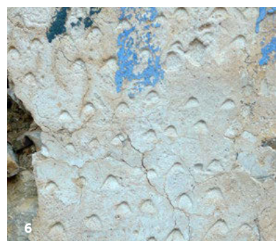
5. Επισκοπή Μυλοποτάμου Ρεθύμνου. Παλιό επίχρισμα από ασβεστοκονίαμα με χαρακτηριστικές γραμμές από χτυπήματα με την άκρη του μυστρίου και σύγχρονες άτεχνες συμπληρώσεις.
